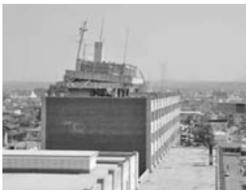
潰れた屋上展望台
